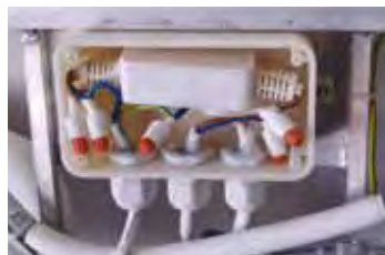
Elementos de seguridad Elements de seguretat
